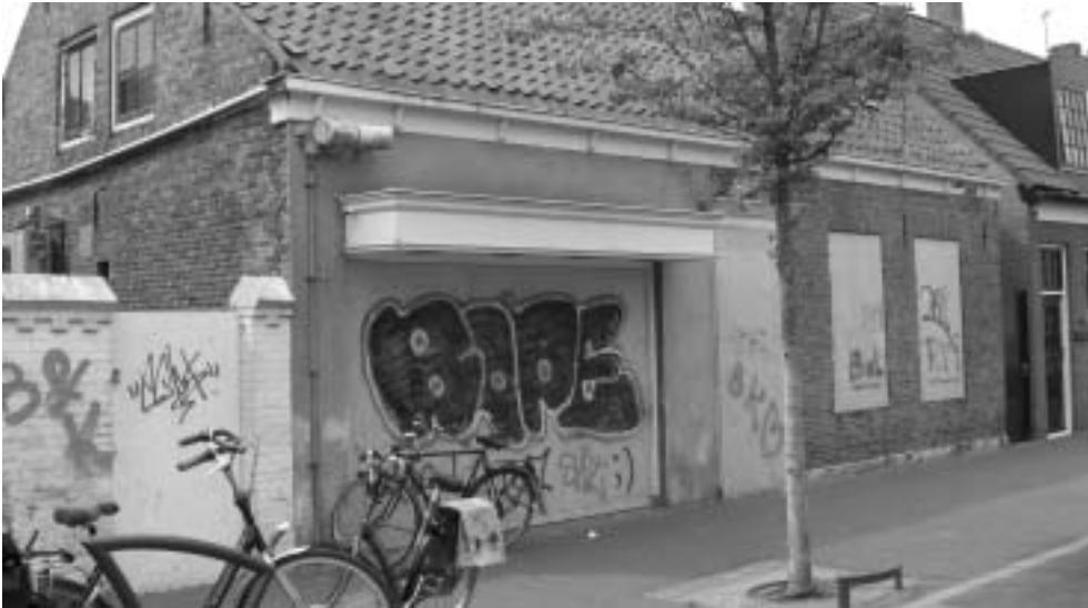
• Het leegstaande winkelpand aan het begin van de Kanaalstraat, inmiddels dichtgetimmerd met houten platen waarop alweer flink wat graffiti prijkt, is – vindt de Nemidso - een heel akelig beeld in de straat
